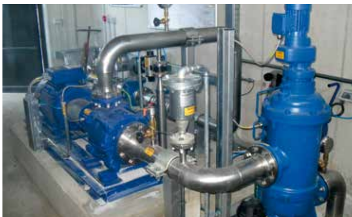
Pumpe für die Beschneigungsanlage
